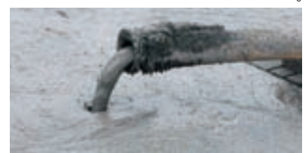
Verpumpen von Kalkschlamm
