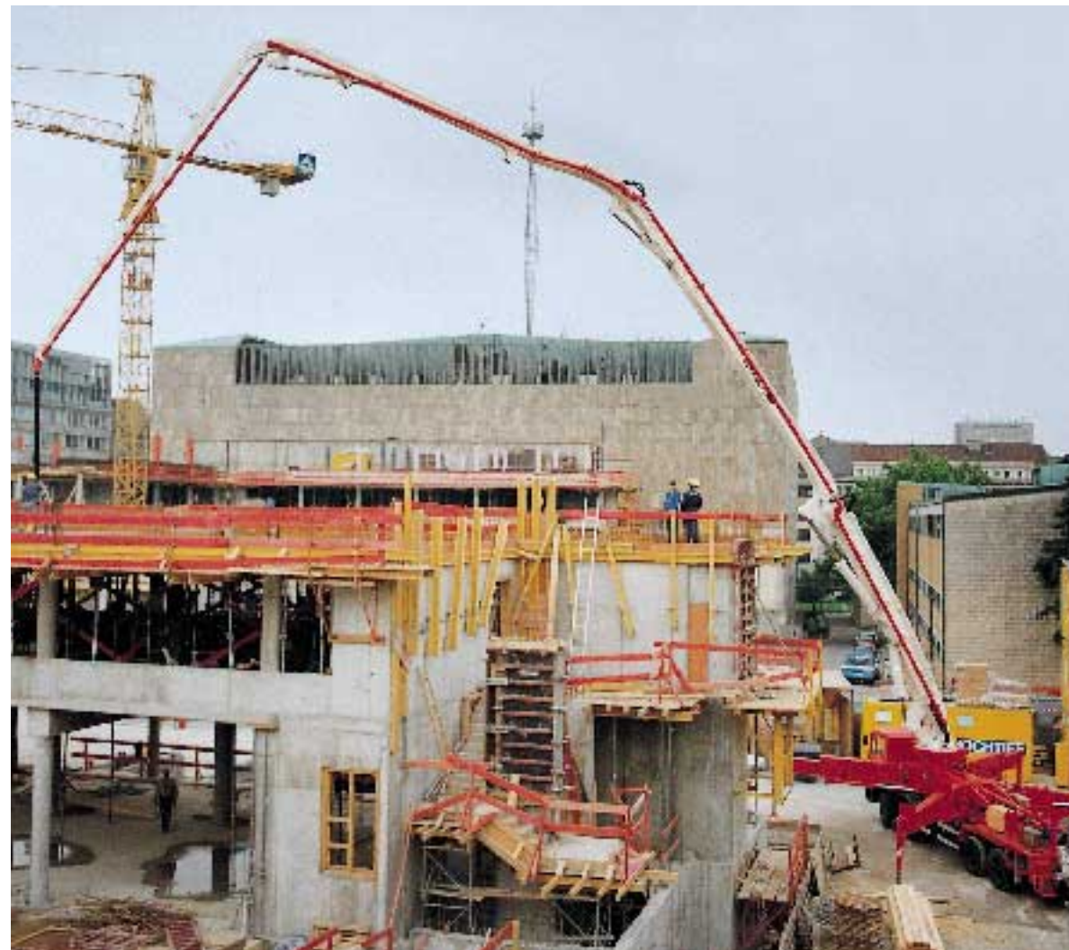
Autobombas de hormigón en la obra con tuberías SK de diferentes niveles de calidad.
