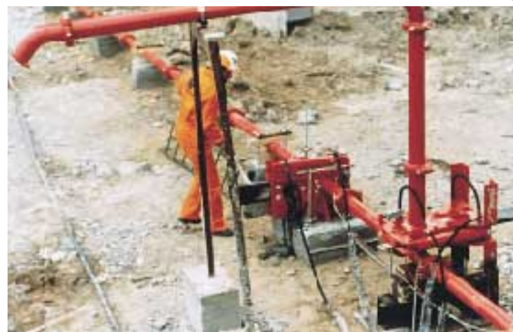
Estación de limpieza mediante sistemas de compuertas de cierre de una tubería de transporte estacionaria.
