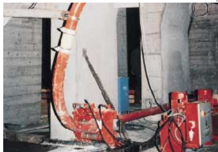
Compuerta de cierre con grupo hidráulico y armario de distribución. Puede operarse también desde un telemando.
